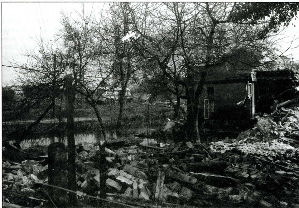
Obr. 4 – Demolice obytných čtvrtí vyvolané poklesem a zaplavení území v prostoru Dolu ČSM ve Stonavě. Snímek J. Havrlanta z roku 1995.
