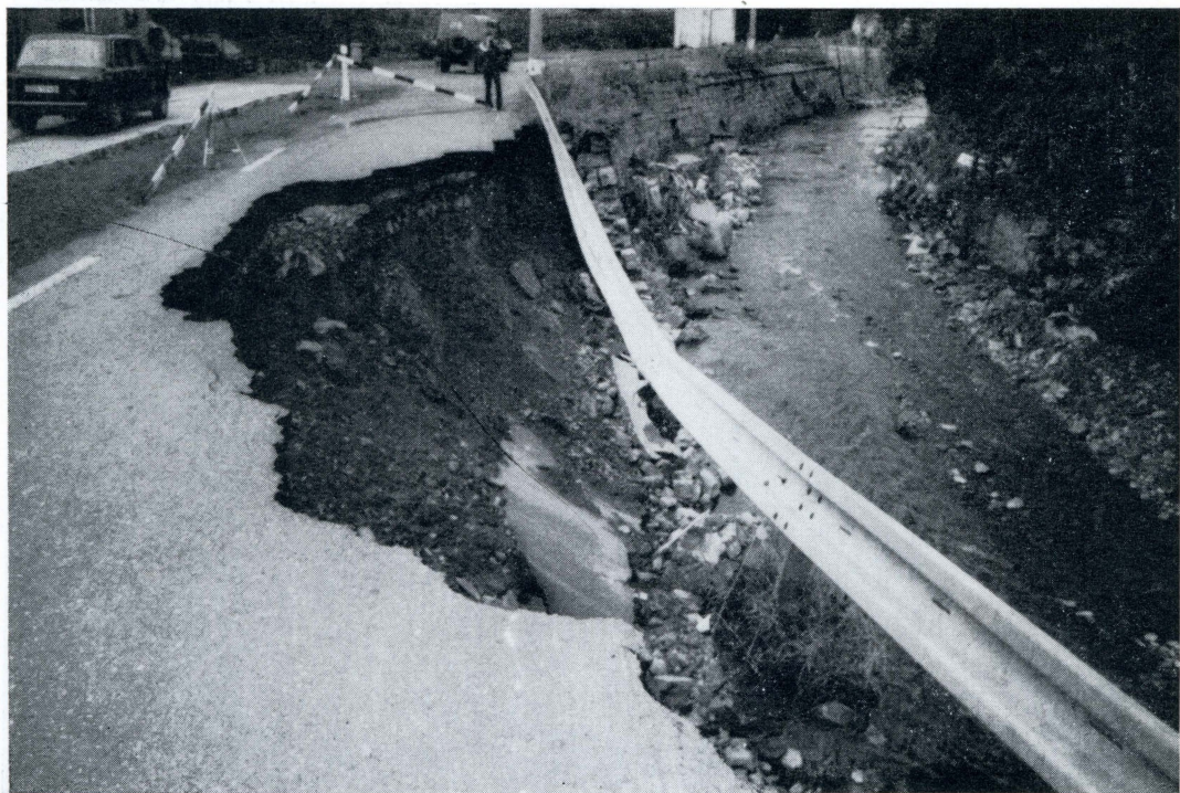
4 — Jílovský potok v Modré — poškození opěrné zdi a silnice. Snímky D. Karlíková.
